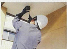
ネットワークケーブルを取り付け
